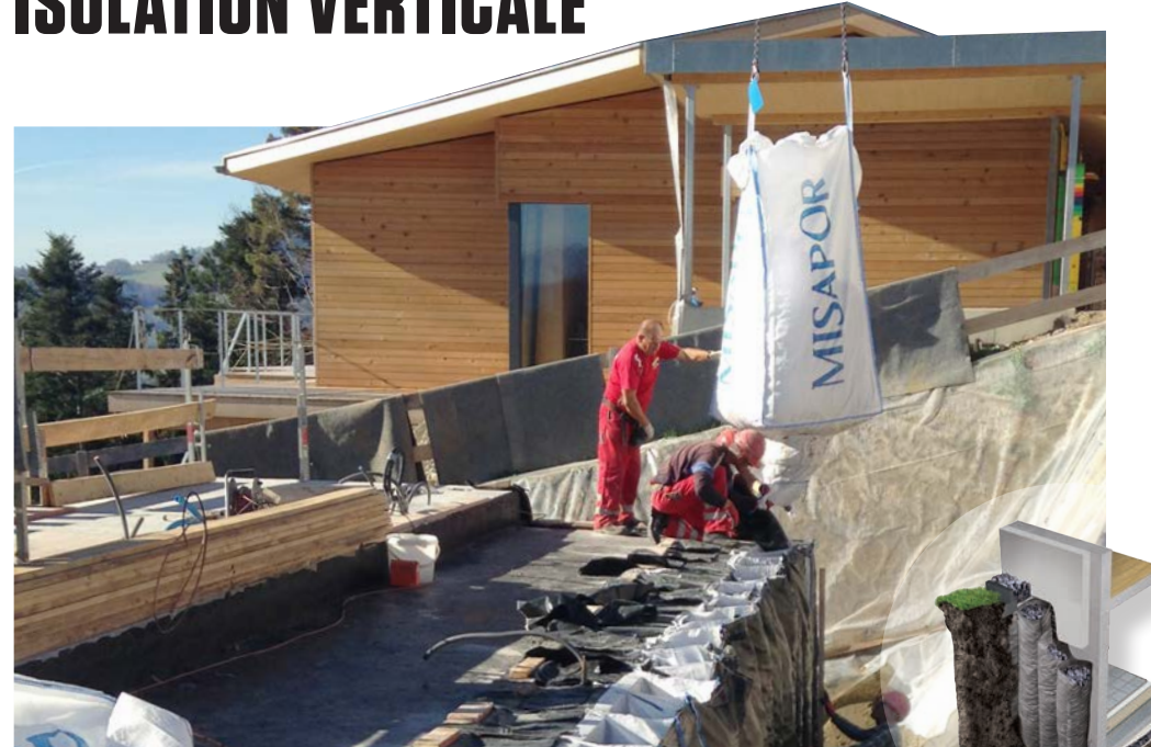
Murs enterrés isolés
